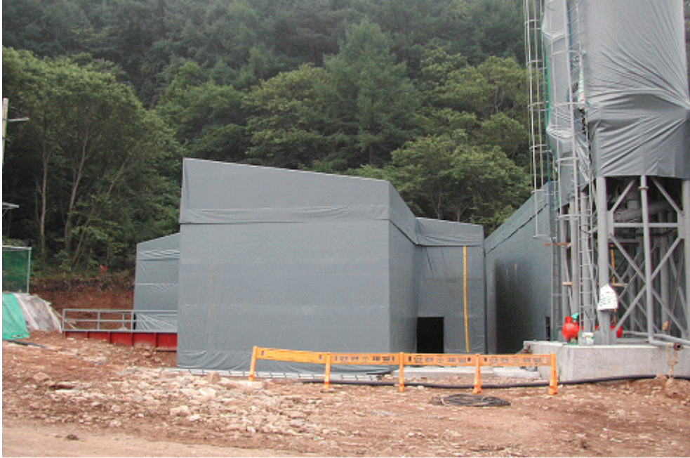
터널공사시 발생되는 폐수를 처리하기위한 폐수처리장 설치 운영 〈경춘선 복선전철 5공구 유담촌터널〉
