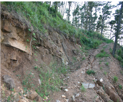
5-1. 해안 인접부 절성토면 붕괴로 도로유실
