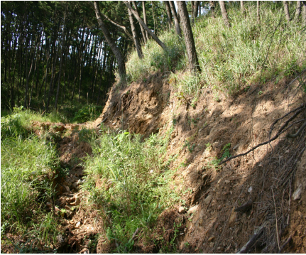
1. 절토면 침식 및 붕괴 진행, 상부 수목 도복 우려
