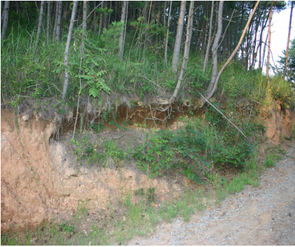
1-1. 절토면 붕괴 및 상부 수목 도복 진행
