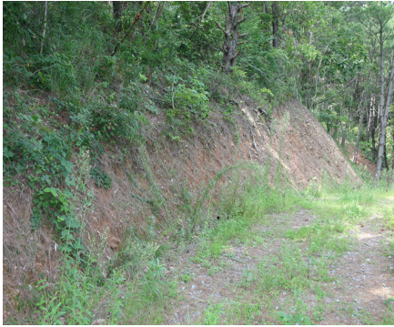
1. 터널 진입로 절토면 훼손
