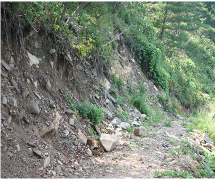
2-1. 절토면 붕괴 및 상부 수목 도복
