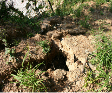
3-1. 바다 인접부 성토면, 노면 크랙 발생 및 붕괴
