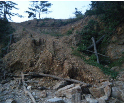
3. 해안 인접부 도로 유실
