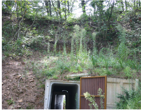
2. 터널 상부 절토면 붕괴 진행
