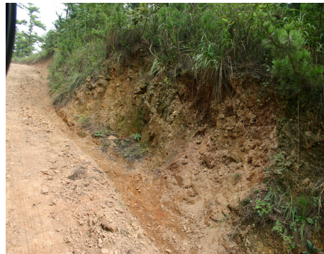
1-2. 임시 설치된 측구 침식 진행
