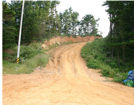
2. 측면 절토면 보강 필요
